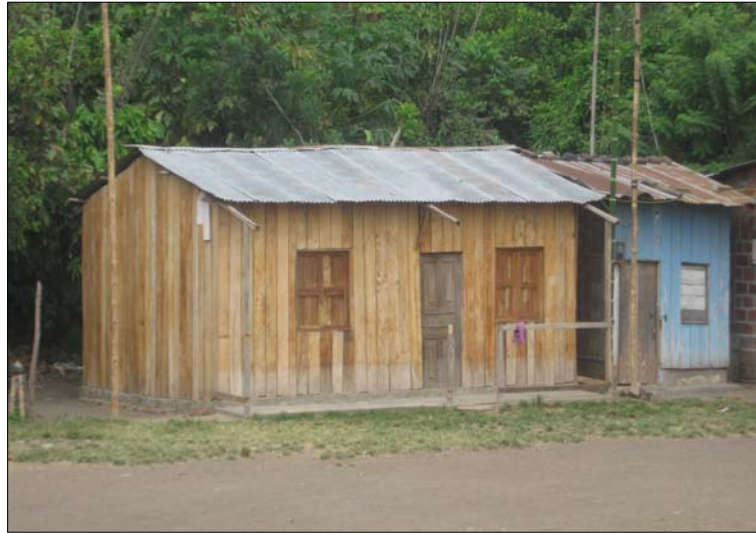
Foto 7. Vivienda de madera; vulnerabilidad alta Fuente: CLIRSEN 2010
