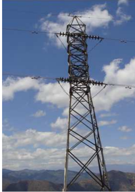
Foto 7. Estructura de la línea de subtransmisión Obrapía – Catamayo. Fuente: UTP, 2011.
