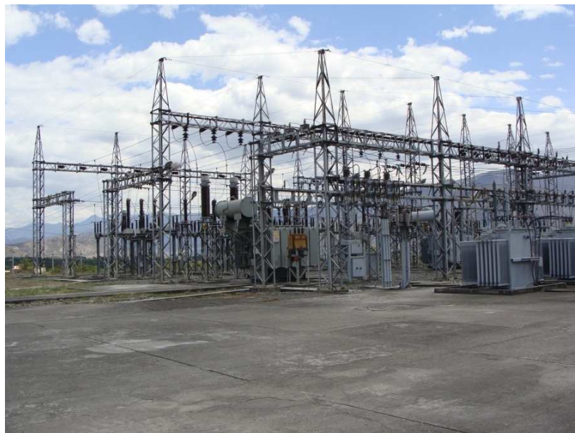
Foto 10. Subestación eléctrica Catamayo Fuente: UTPL, 2011
